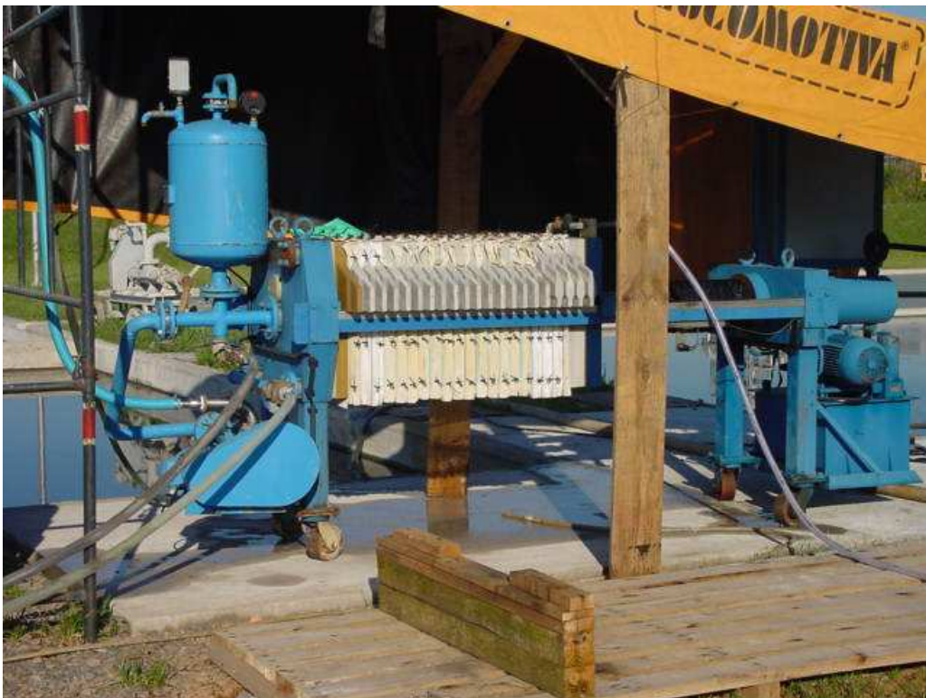
Instalação do filtro prensa
